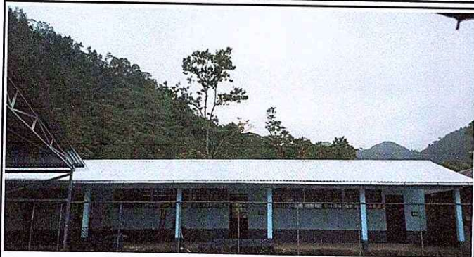
Foto1: Culminacion laminas que estaban en mal estado
